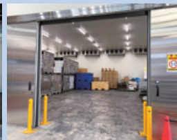
冷蔵施設内の様子
